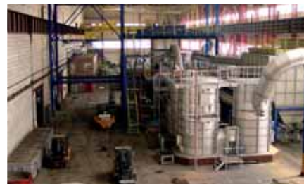
ТОВ "Укрсплав". Шахтно-плавильний комплекс з вежами охолодження
