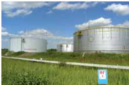
Резервуарний парк АВДС "Новоград-Волинський"
