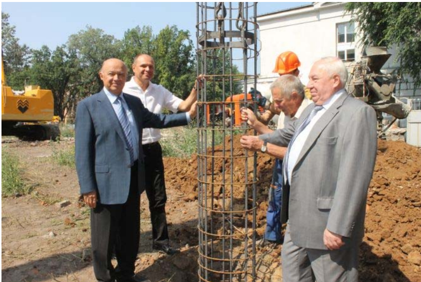
6 липня 2012 р. відбулася церемонія заливки бетоном першої залізобетонної 12-метрової палі на будівництві нової бібліотеки університету
