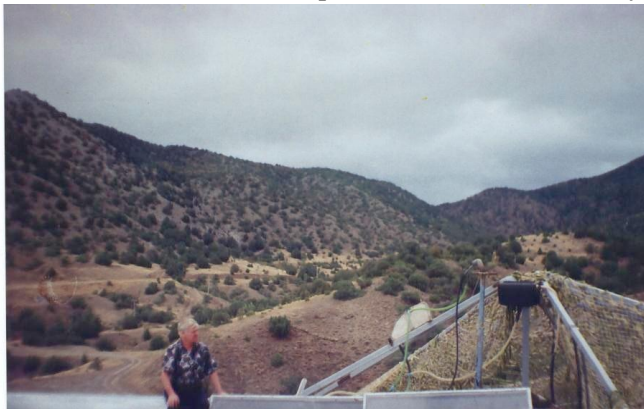
Монтаж солнечных нагревателей воды в столовой турбазы в районе посёлка Новый свет
